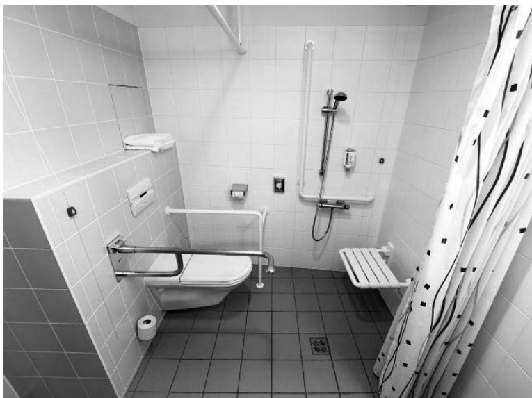
Rollstuhlgerechte Nass-einheit im Kolpinghaus
